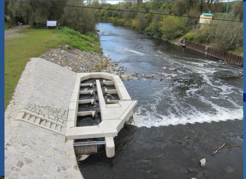
Stupeň na Olši ve Věřňovicích s migrační rampou na LB
